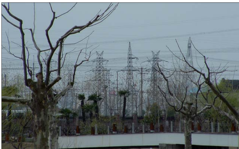
Bild 6. Umspannwerk bei Shanghai
