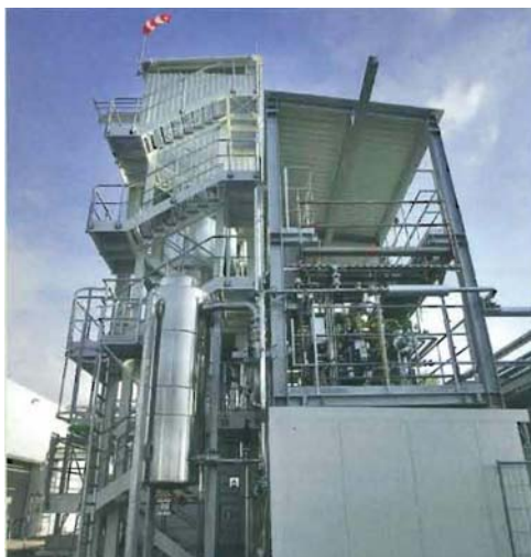
Bild 8: Methanisierungsanlage mit Festbettreaktor und Wärmeabfuhr über eine Salzsammelzelle (e-Gas-Anlage Werlte [25])
