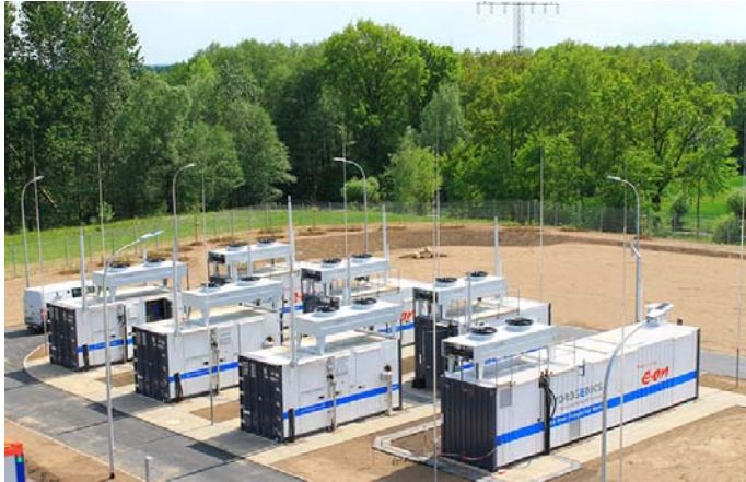
Bild 12: Power-to-Gas-Anlage der E.ON in Falkenhagen [58]
