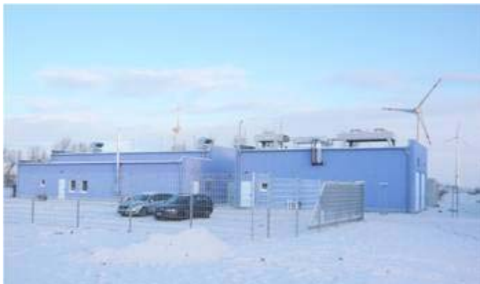
Bild 11: Power-to-Gas-Anlage RH 2 -WKA in Grapzow [56]
